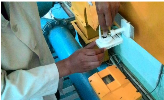
pemasangan IP camera pada alat ukur laju alir
