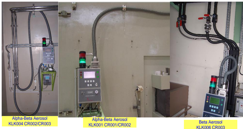
Gambar 6. Instalasi pengembangan jalur pencuplik udara
