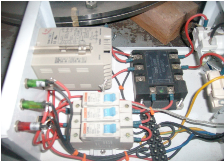
Gambar2. Instalasi sistem kontrol temperatur
