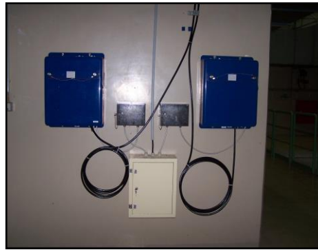
Gambar 4. DSOS Server 3 dan Server 4
