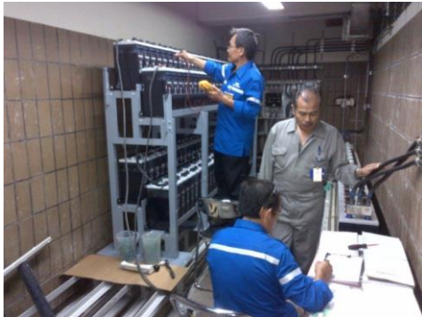
Gambar 6. Pengukuran baterai BTDO3
