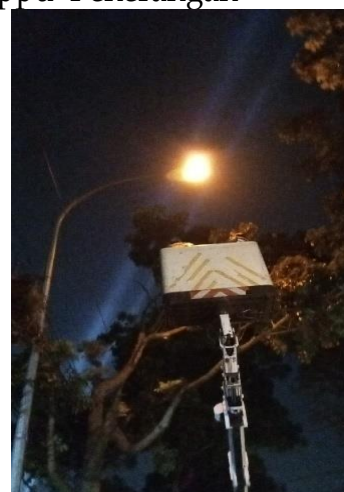
Lampu Penerangan Sodium
