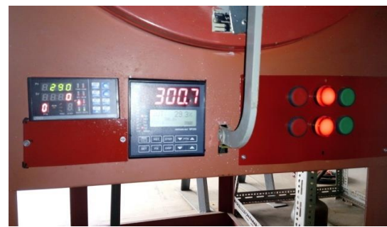
Gambar 16. Instalasi kendali sistem pemanas dengan menggunakan kontrol magnetis
