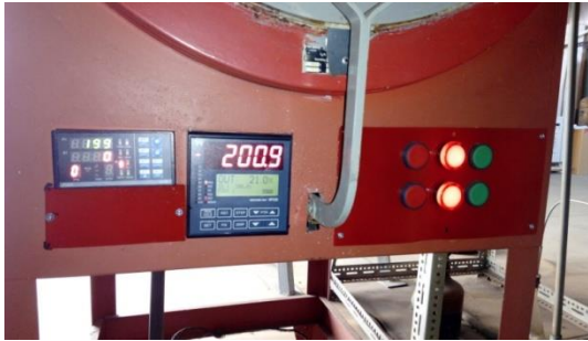
Gambar 18. Tampilan Uji Fungsi Tungku Kalsinasi suhu 200 °C
