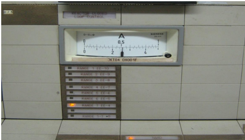
Gambar 5. Unjuk kerja kanal jangkau lebar (JKT04) (kanal pengatur daya)
