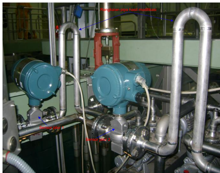
Gambar 3. Instalasi pipa pendingin sekunder pasca modifikasi
