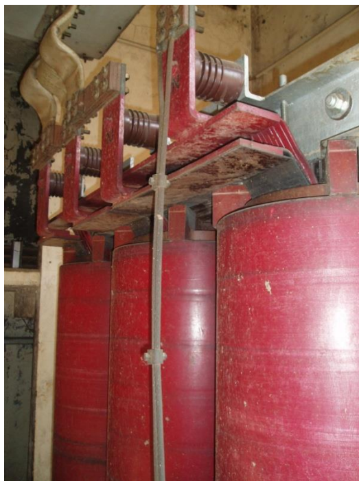
Gambar 2. Transformator kering BHT01/02
