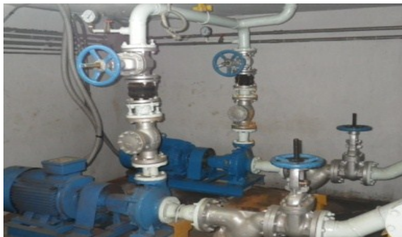
Gambar 1. Sebelum dilakukan perbaikan
