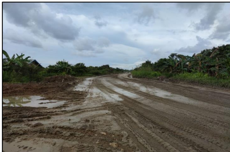
Gambar 3.1 Kondisi Jalan Licin dan Berlumpur
