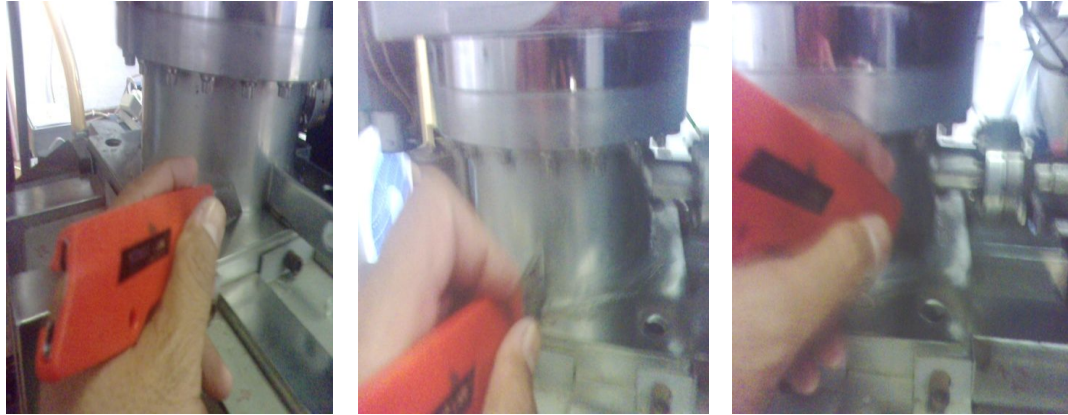
Gambar 9. Perbaikan kebocoran pada pipa penghubung antara pompa ionik 1 dengan ruang sumber ion
