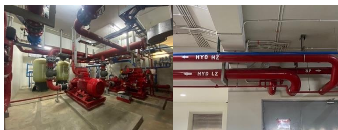
Gambar 6. Ruang Pompa dan Pipa Aliran Air
