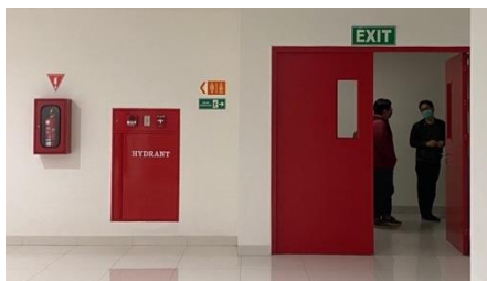
Gambar 7. Lokasi Penempatan APAR
