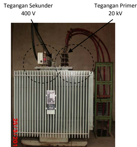
Gambar 1. Transformator BHT03 RSG-GAS tipe berpendingin minyak [2]
