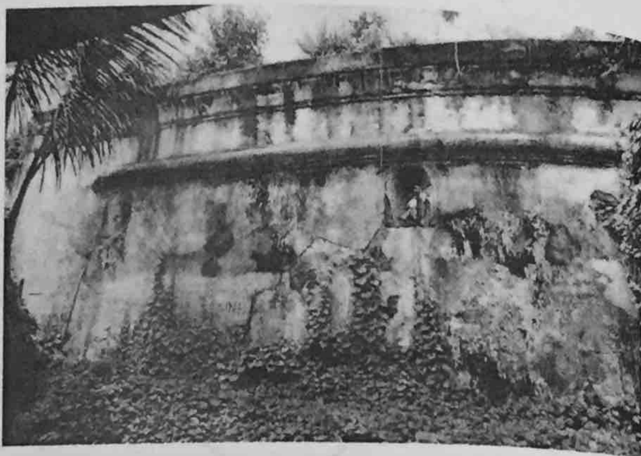
Foto 2 Celah intai tampak dari bagian luar tembok Timur laut
