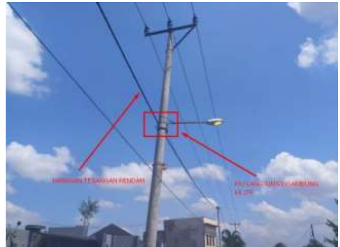
Gambar 2. PJU yang tidak termeterisasi (illegal)
