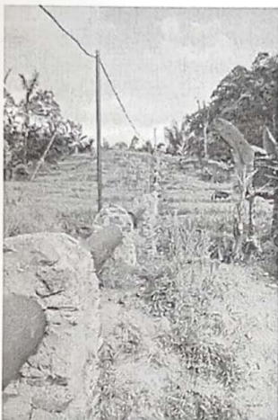
Pipa penstock dan kabel jaringan
