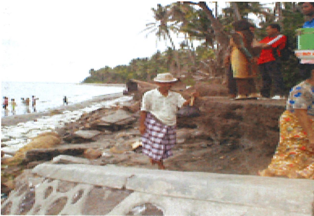
Gambar 10. Abrasi Pantai Dan Tanggul yang hancur Akibat Gempuran Ombak dan Arus Laut yang Kuat 32
