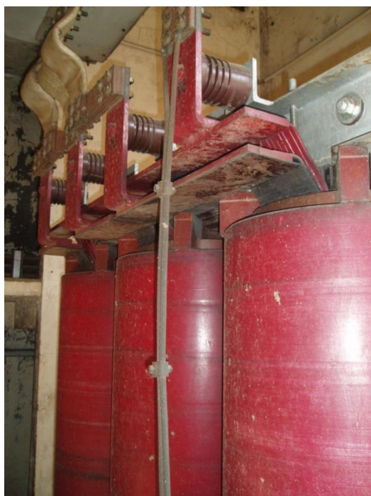
Gambar 2. Transformator kering BHT01/02
