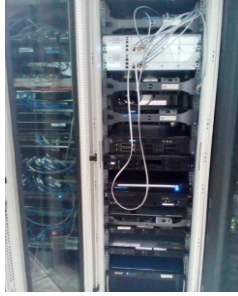
Gambar 4-2: Rak Server Fisik (Sumber : Dokumentasi Pustikpan, 2018)
