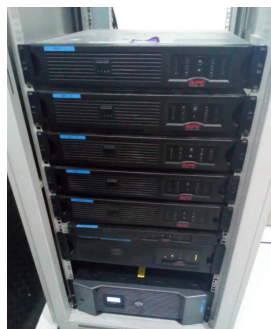
Gambar 4-4: Rak UPS (Sumber : Dokumentasi Pustikpan, 2018)
