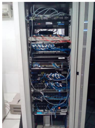
Gambar 4-1: Rak Peralatan Jaringan (Sumber : Dokumentasi Pustikpan, 2018)
