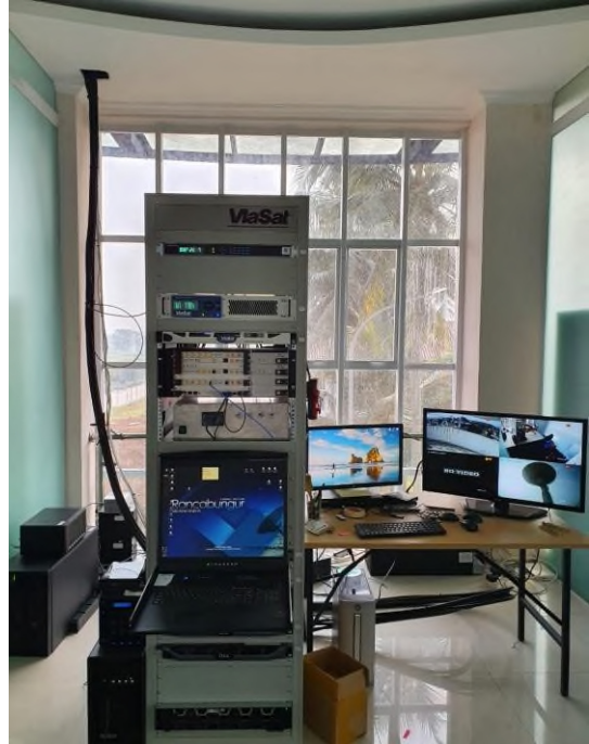
Gambar 2.2 Ruang server receiver dan transceiver yang berisikan modem modem antena Viasat 11.28 Meter
