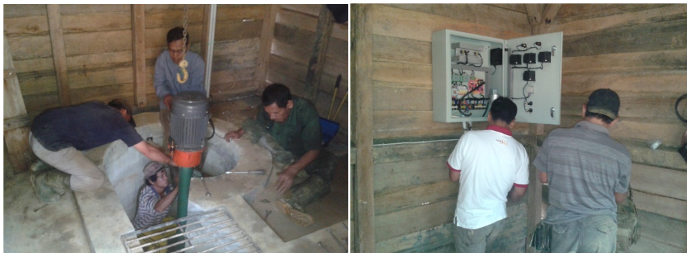
Gambar 14. Instalasi turbin dan peralatan pendukungnya
