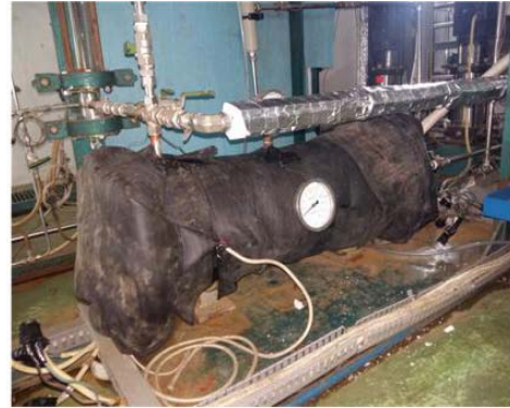
Isolasi Pre-cooler dengan Thermaflox
