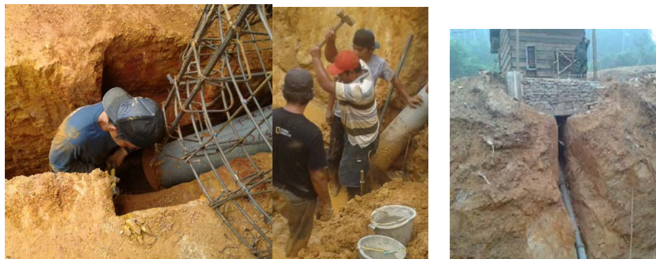
Gambar 13. Instalasi pipa pesat saluran pembuangan turbin
