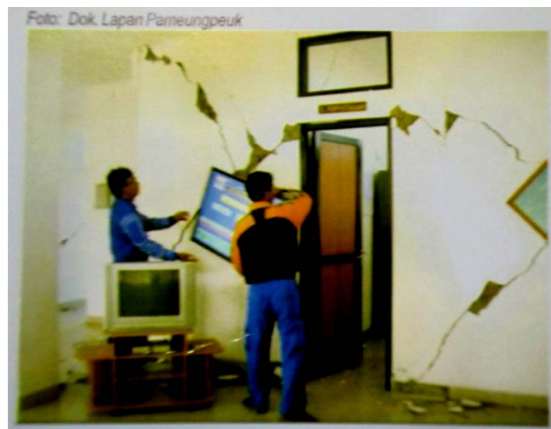
Gambar 1.1 : Ruang Di Kantor LAPAN Pamengpeuk Retak Bagian Dindingnya
