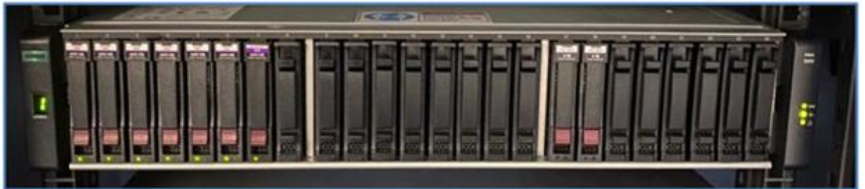
Gambar 8. Server SAN yang telah terpasang pada rak 6 U39-40
