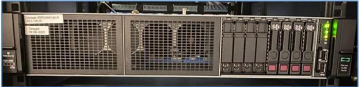
Gambar 7. Server Web/Storage yang telah terpasang pada rak 6 U42-43
