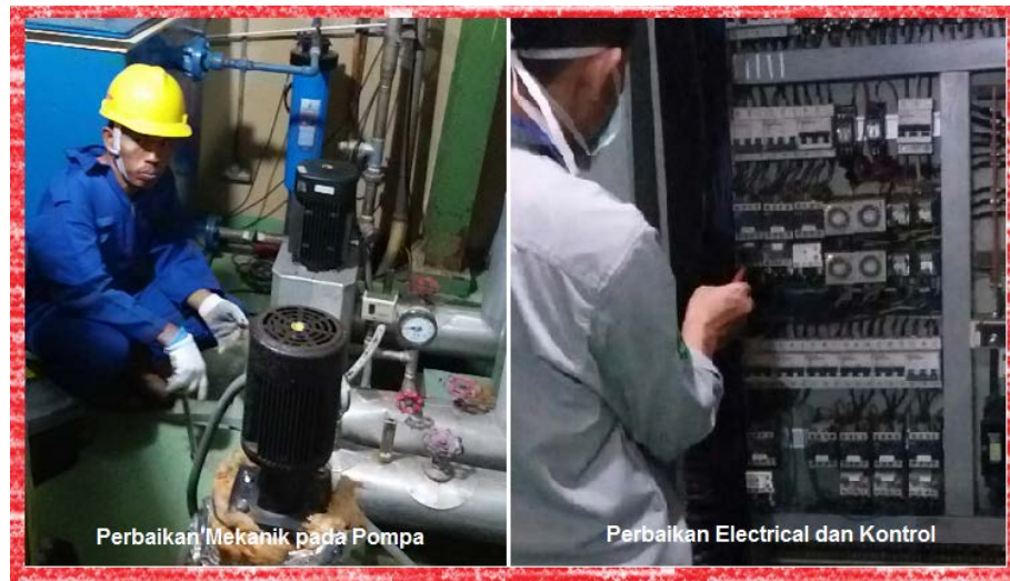
Gambar 5. Perawatan pompa sistem pendingin kolam
