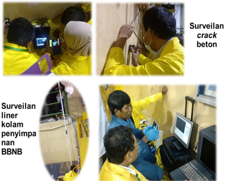
Gambar 3. Kegiatan pengujian tebal liner dan retak beton.
