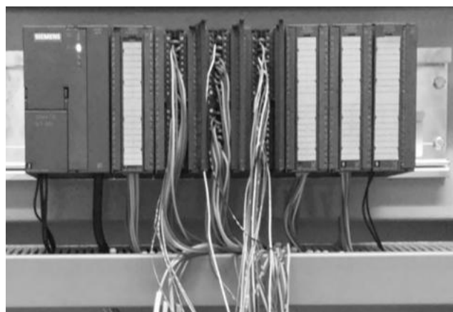
Gambar 8. Instalasi kabel input PLC Siemens S7-300
