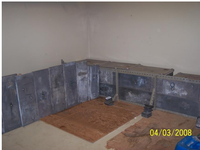
Perisai Radiasi Di Dalam Ruang Penyimpanan Batu Topaz
