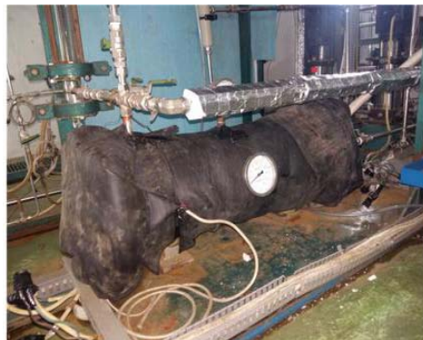
Isolasi Pre-cooler dengan Thermaflex
