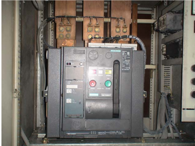
Gambar . Incoming Air Circuit Breaker Pada Jalur BHC
