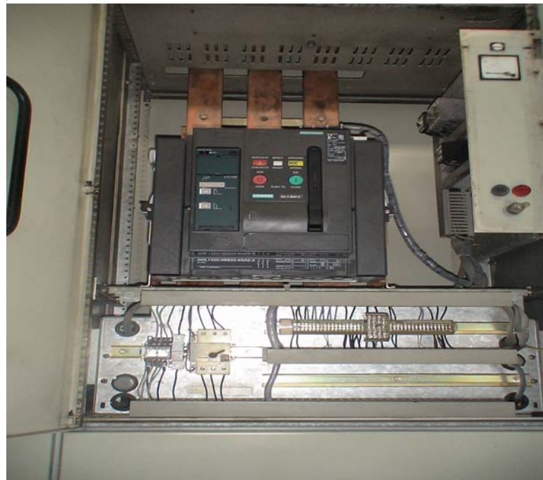
Gambar . Outgoing Air Circuit Breaker Pada Jalur BHB
