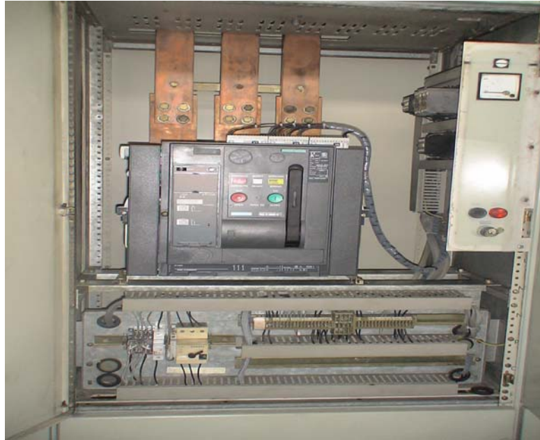
Gambar . Incoming Air Circuit Breaker Pada Jalur BHB
