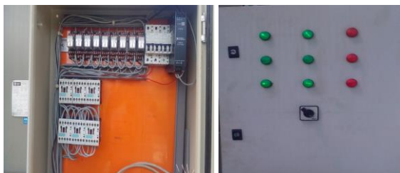
a). Panel kontrol b). Lampu Panel kontrol
