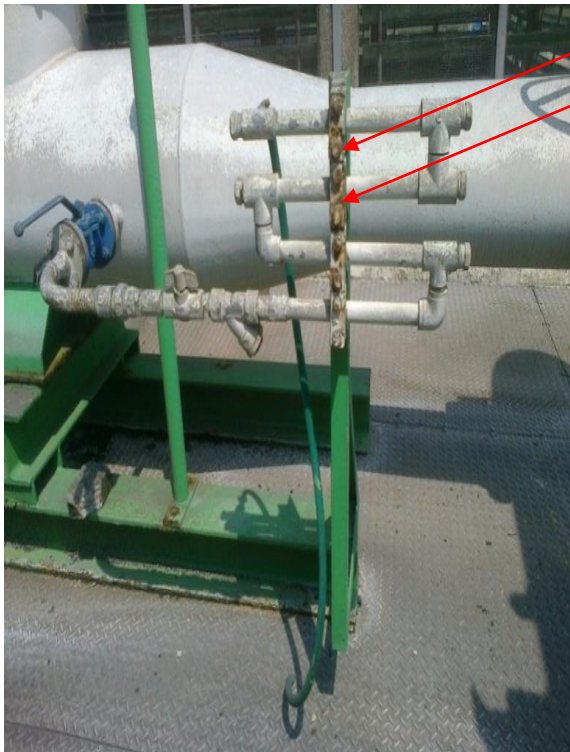
Gambar 4.1: posisi pemasangan coupon corrosion pada rangkaian rak coupon
