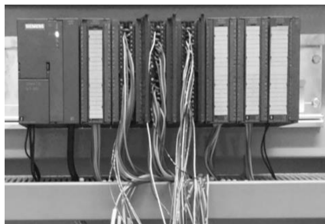
Gambar 8. Instalasi kabel input PLC Siemens S7-300
