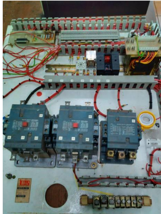
Gambar 10. Panel kompresor CO. 231 yang akan direvitalisasi
