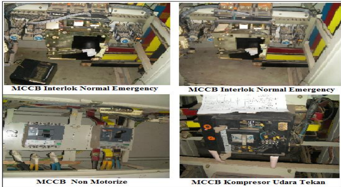
Gambar 5. MCCB yang harus diganti dan dilengkapi motorize
