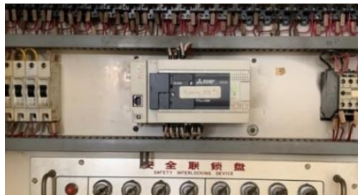
Gambar 6. Panel Rapping Control PT. DSS menggunakan PLC Mitsubishi
