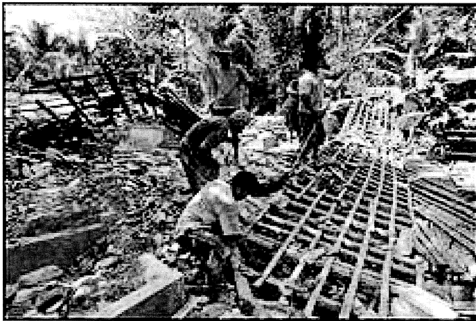
Gambar 3.1. Evakuasi Korban Gempa yang Dilakukan Para Laki-laki di Kabupaten Bantul Tahun 2006
