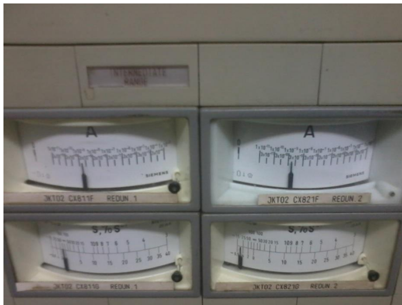
Gambar 4. Meter kanal pengukuran jangkauan menengah (JKT02).
