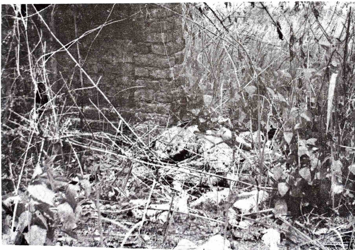
Foto 2: Dampak negatif pembangunan pagar pura sisi selatan
