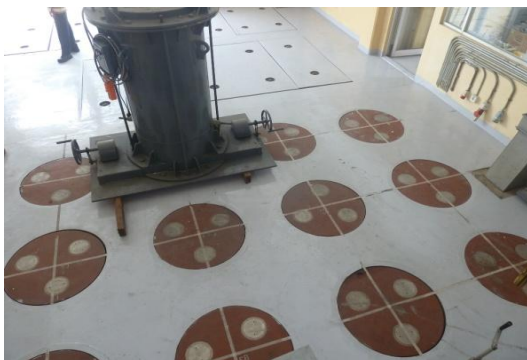
Gambar 1. Fasilitas penyimpanan tipe sumuran
