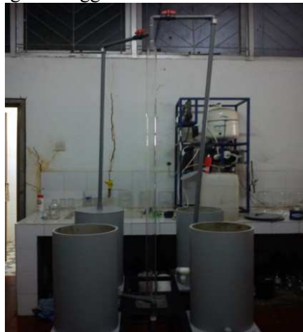
Gambar 4.4. Kolom Ion exchange
