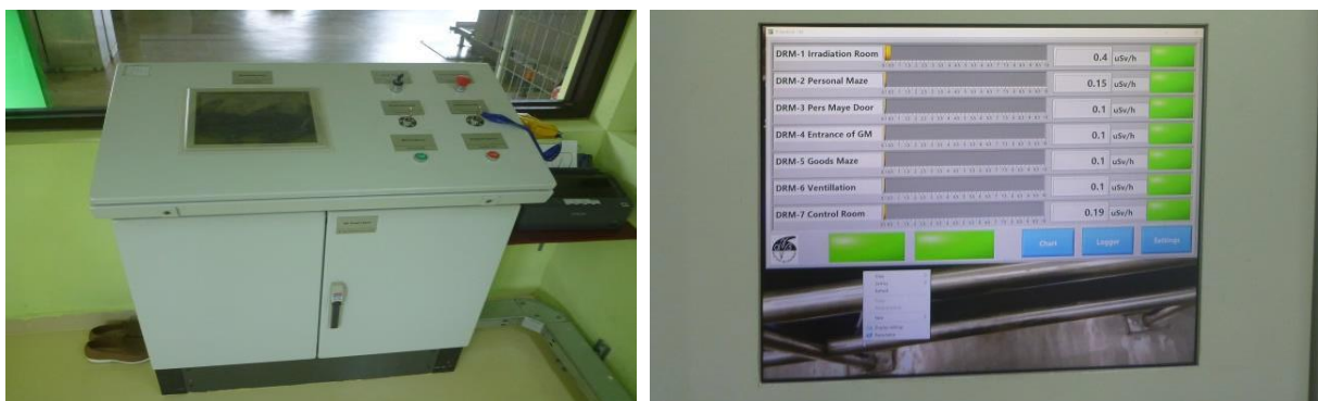
Gambar 3.17. Konsol kendali iradiator serta tampilan monitoring radiasi yang digunakan oleh operator di dalam ruang kendali utama iradiator gamma merah putih
