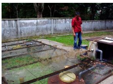
Perawatan pompa kolam limbah cair
